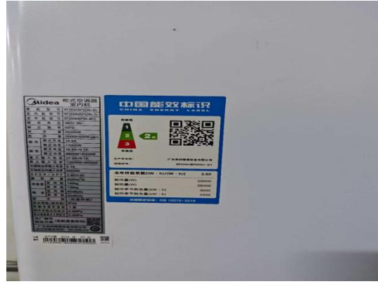
管排锯电气室空调
