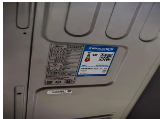
管坯预热炉电气室空调
