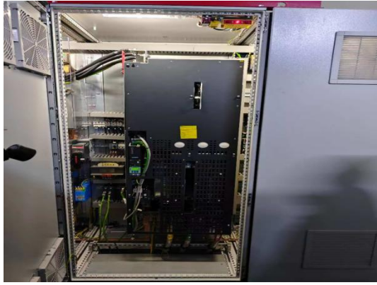
管排锯电气室配电柜
