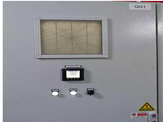
管排锯电气室配电柜
