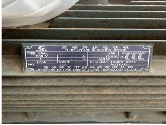
油环冷却塔风机电机
