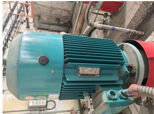
滤液提升泵电机
