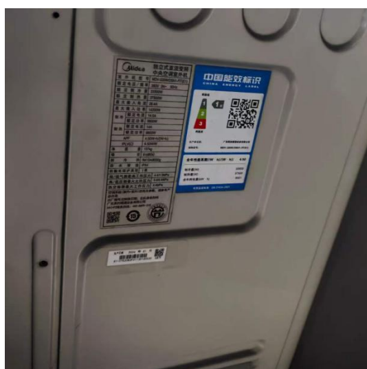
预热炉电气室空调照片
