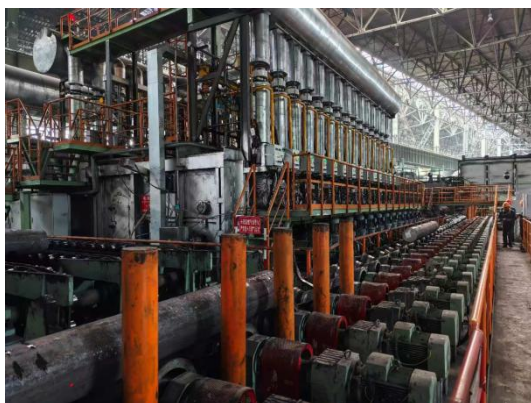
管坯预热炉辊道
