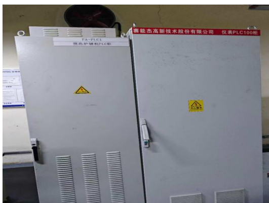
管坯预热炉电气室电器柜
