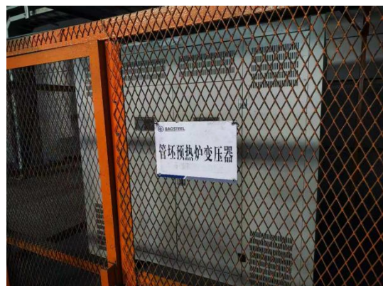
管坯预热炉变压器
