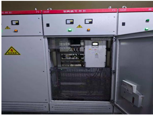
管坯预热炉电气室引风机变频柜
