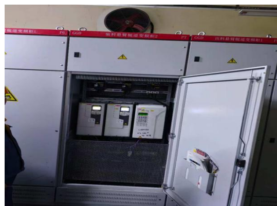
管坯预热炉电气室变频柜
