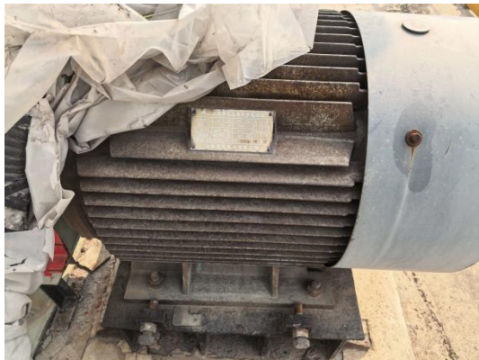
净环冷却塔风机电机
