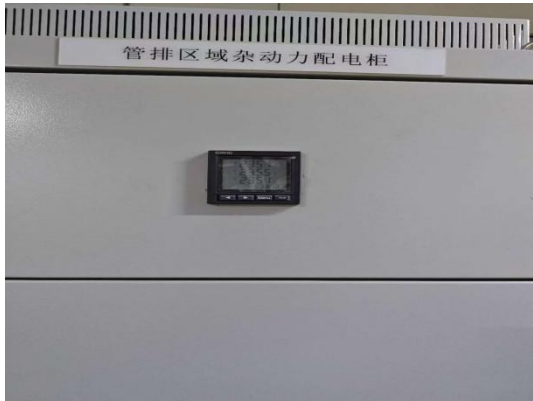
管排锯电气室配电柜
