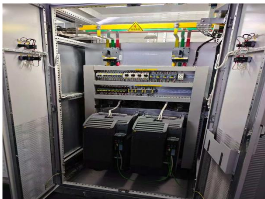
管排锯电气室配电柜
